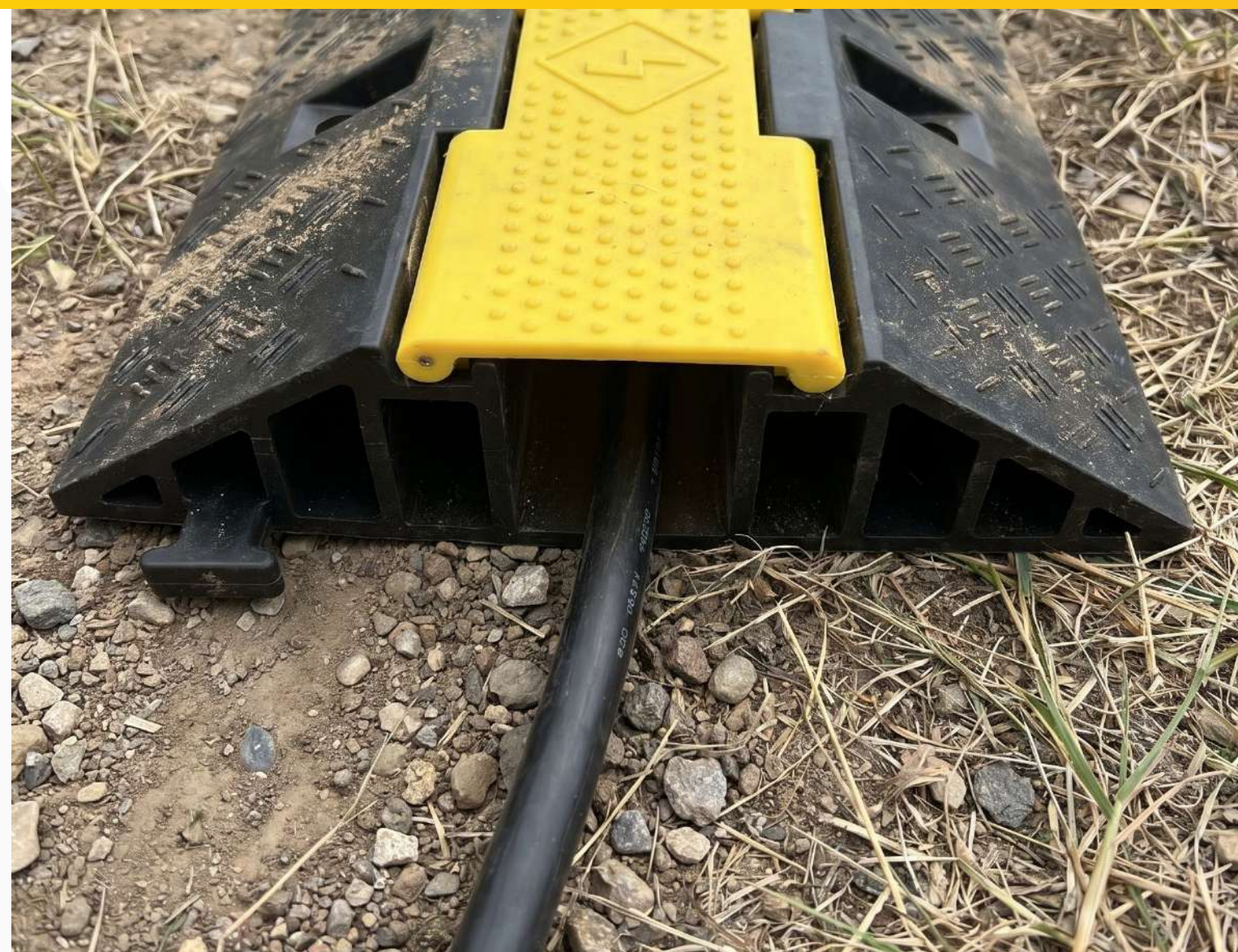
Кабель каналы для защиты коммуникаций
