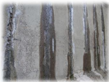
Рисунок 4 - Сочащиеся протечки через швы, трещины бетонной конструкции
