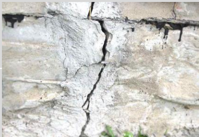
Коррозийное разрушение фундамента
