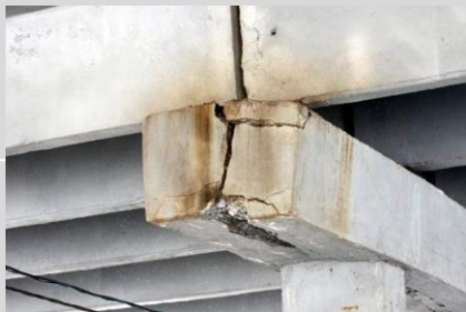
Разрушение несущих конструкций, образование солевого нароста
