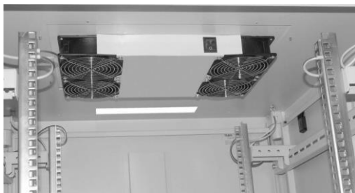
Установленный вентиляторный блок в шкафу
