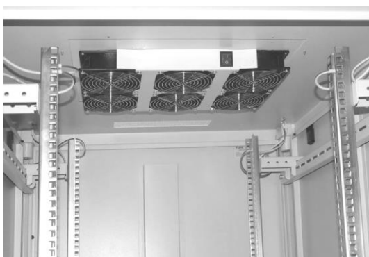
Установленный вентиляторный блок TLK-FAN6-GY в шкафу
