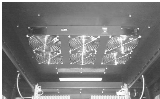
Установленный вентиляторный блок TLK-FAN6-BK
