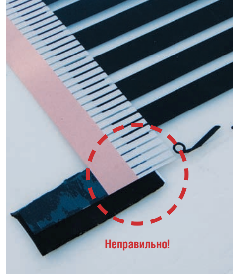
Рис. 14. Пример неправильной установки изоляции линии отреза медной шины
