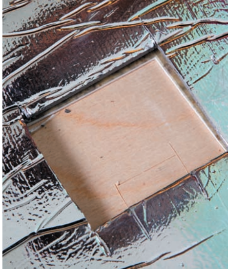
Рис. 24. Отверстие под датчик температуры пола в теплоотражающем материале
