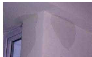
Осмотр утечки воды в помещении
