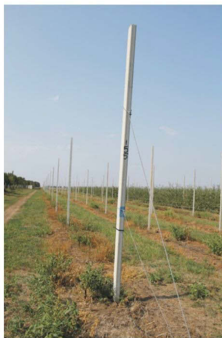
Железобетонные шпалерные столбы
