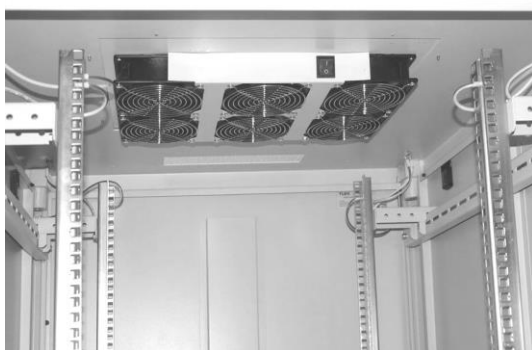
Установленный вентиляторный блок TLK-FAN6-GY в шкафу
