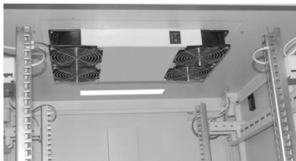
Установленный вентиляторный блок в шкафу
