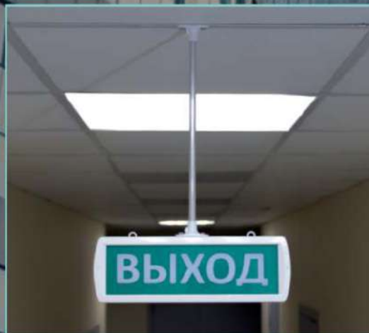
«ТРУБКА» К ПОТОЛКУ
