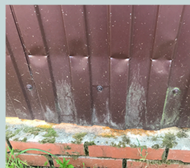
Пораженная поверхность через 24 часа после нанесения раствора.
