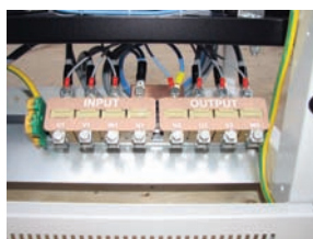
Oberon Y45-15: тороидальный вариатор, вольтодобавочный трансформатор
