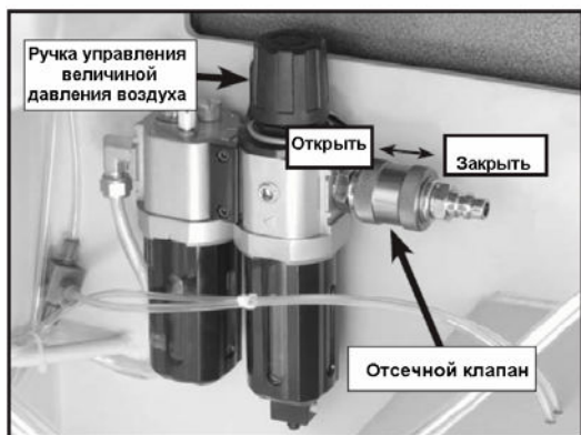
Рис. 16. Установленная внутри станины станка группа "фильтр-редуктор-лубликатор".
