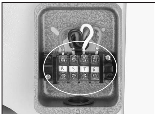
Рис. 28. Основная соединительная колодка, расположенная внутри электрической коробки снаружи станины станка.
