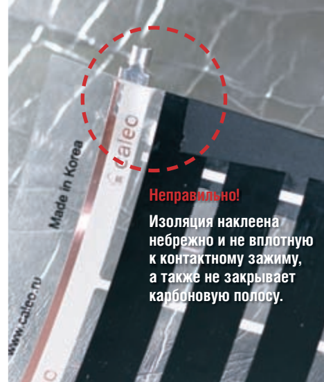
Рис. 13. Пример неправильной установки ПВХ изоляции
