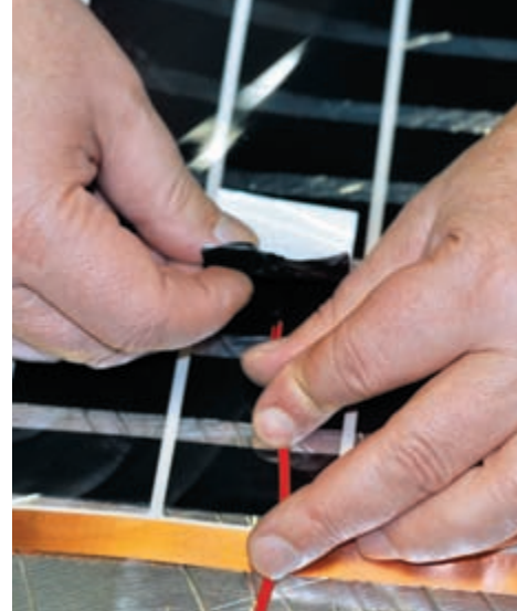
Рис. 24. Датчик прикрепляется к термопленке битумной изоляцией
